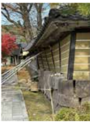
⑦ 傾いた塀と回廊(2)
